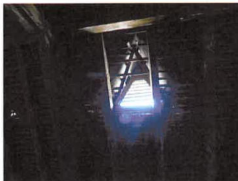
Foto nr.15 Lucarne precar protejate
