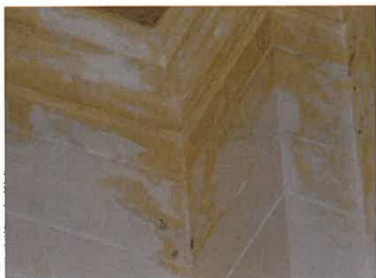
Foto nr.3 Tencuieli degradate de infiltrații
