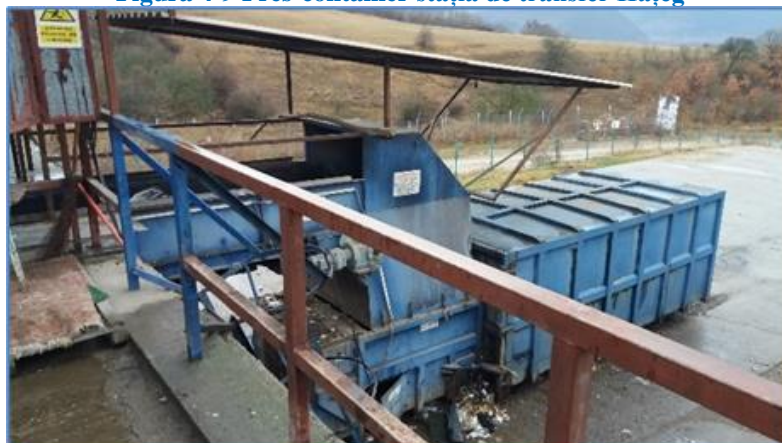
Figura 4-9 Pres-container stația de transfer Hațeg
