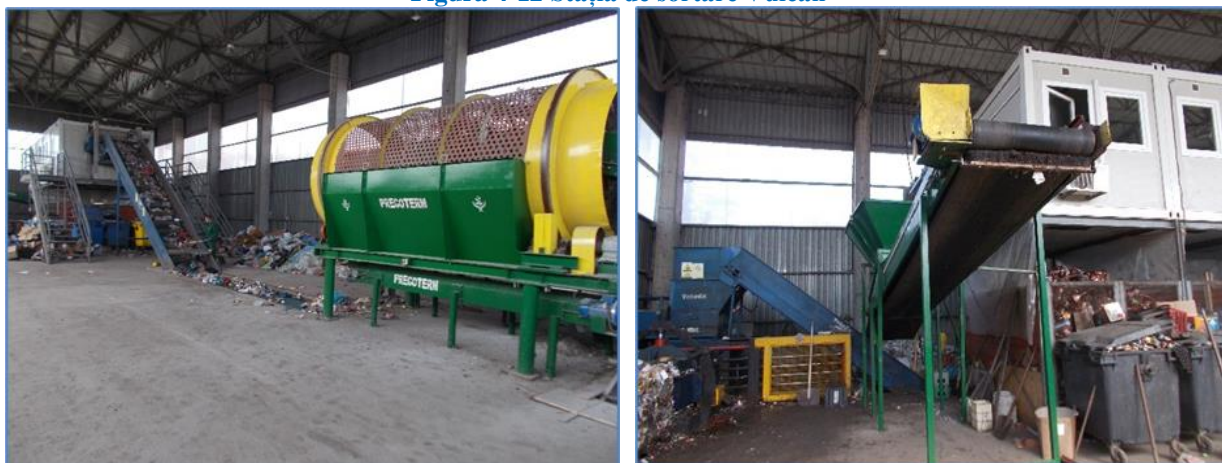
Figura 4-12 Stația de sortare Vulcan
