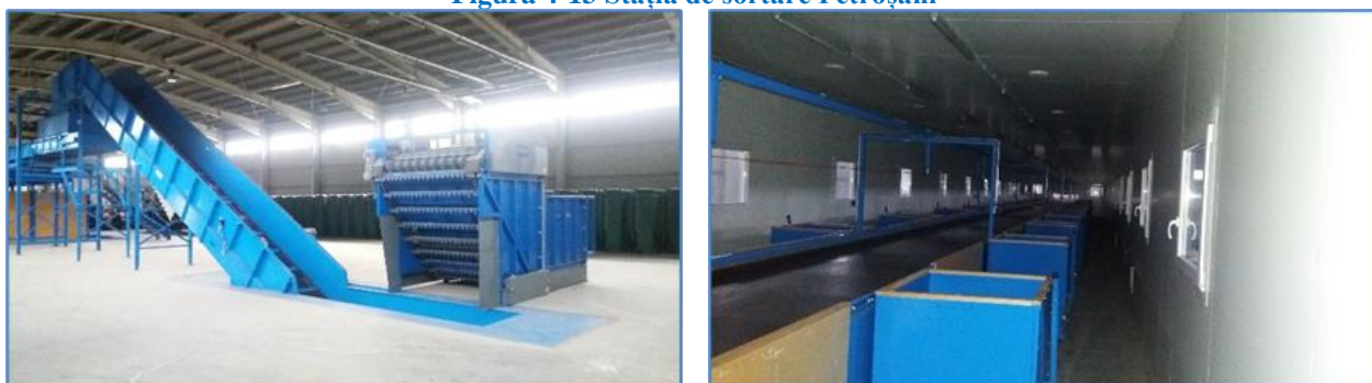
Figura 4-13 Stația de sortare Petroșani
